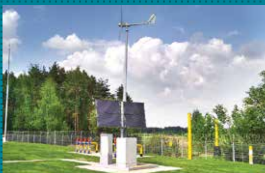
ПЭКЗ с питанием от солнечных батарей и ветрогенератора
